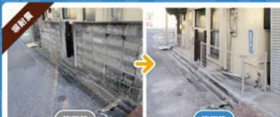
高知市 O様 ブロック塀にひび割れが発生!! 子供達の通学路なので、これでひと安心。補助金を申請して耐震工事を施工しました。
